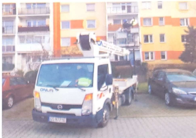
Fot. Wymiana żarówek na energooszczędne na terenie osiedla
