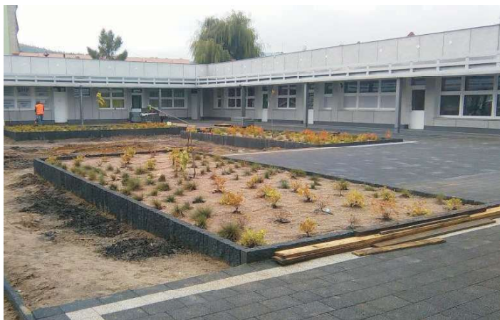
Pawilon pięknie, ale niestety stał się już obiektem zainteresowania wandalów
