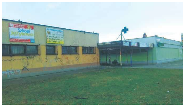
Elewacja pawilonu przy ul. Stoczniewców 7 wymaga remontu
