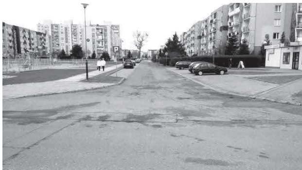
Obecnie stan drogi jest bardzo zły
