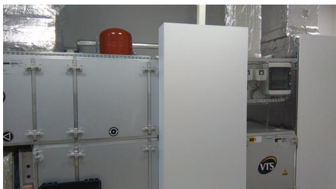
W Domu Kultury gotowe jest już pomieszczenie techniczne wraz z systemem sterującym klimatyzacją
